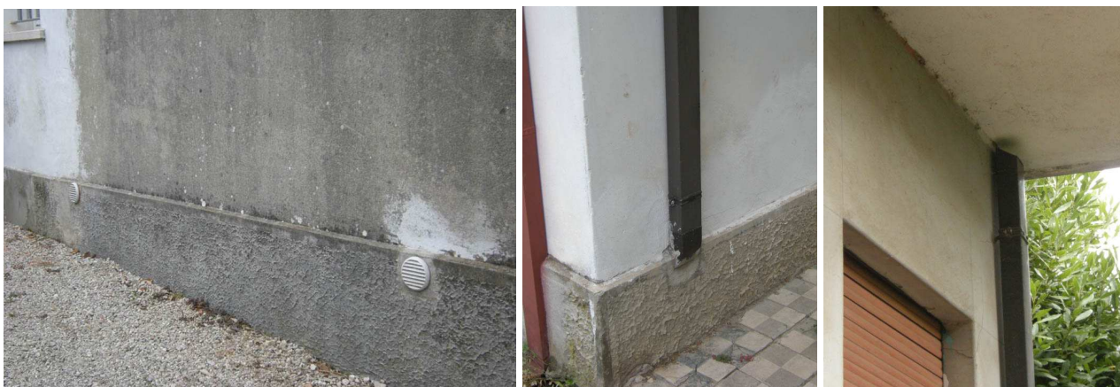
Pavimento ventilato (prese d'aria a nord e tubi di uscita a sud)
